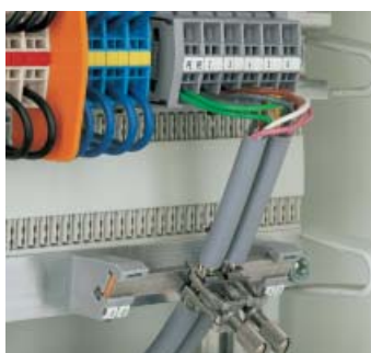
Установка на сборной шине с зажимами
