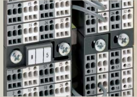
Матричные коммутационные панели установлены в линию для экономии пространства
