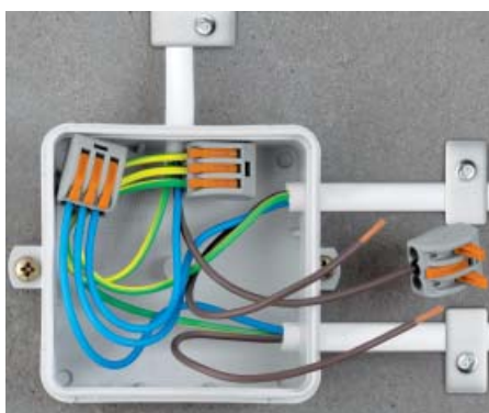
Подключение гибких проводников в распределительной коробке
