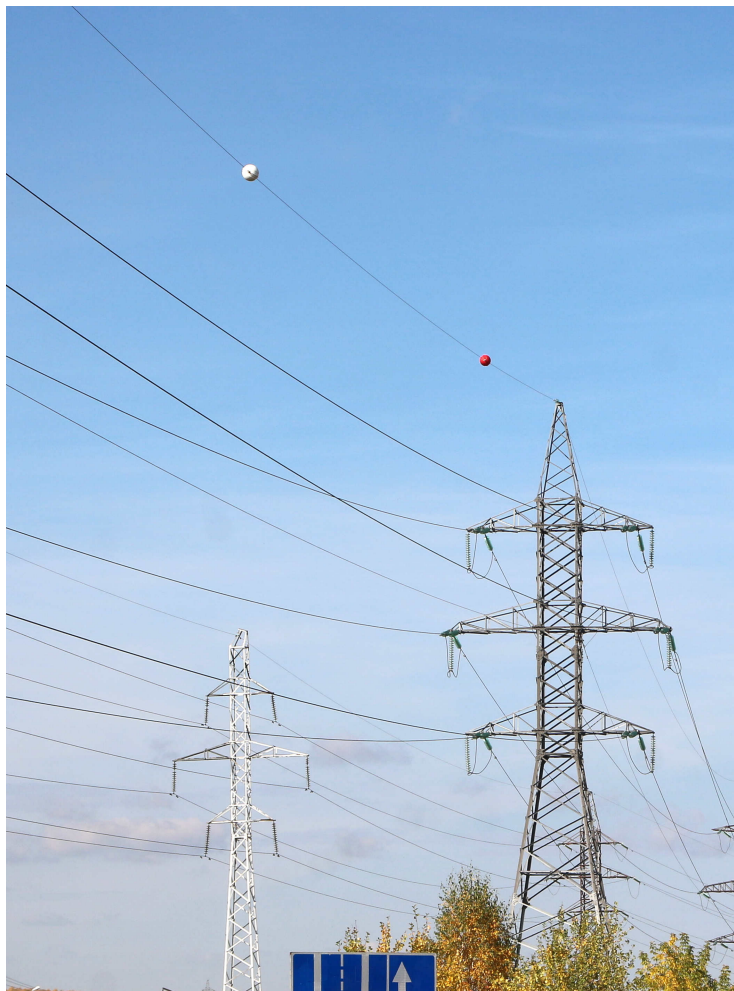
Рисунок 88 Опора линии электропередач. В самом верху натянута грозозащитный трос, который работает молниеприемником. Для безопасности пилотов на тросе закреплены яркие пластиковые сферы, так линии электропередач гораздо заметнее с высоты.
